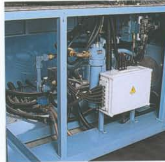
Filtraggio a bassa pressione dell'olio Oil low pressure filtering system Sistema de filtrage à basse pression a baja presión
